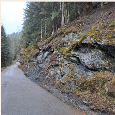
Purge route du crôt
