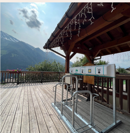
Borne de recharge VTAE à la station
