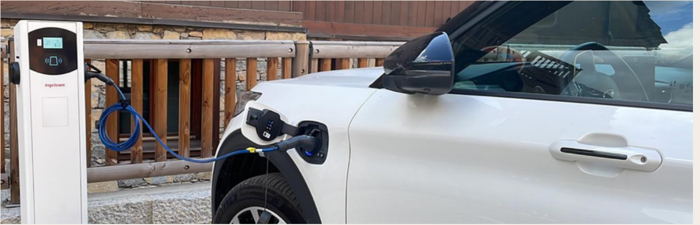
Borne de recharge véhicule à la station
